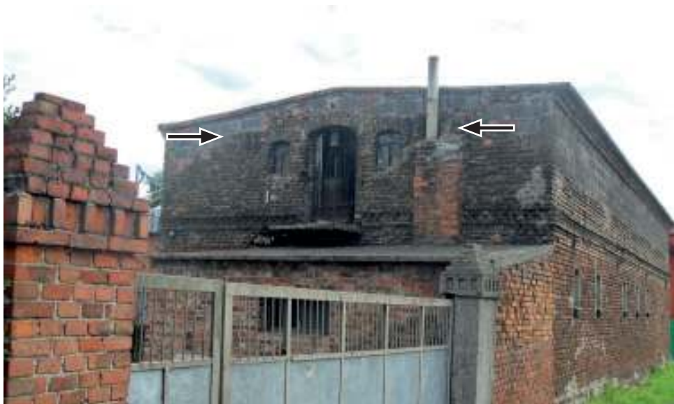
Zabudowanie gospodarcze z 1887 roku (data nad oknami na szczycie) – fot. archiwum autora
